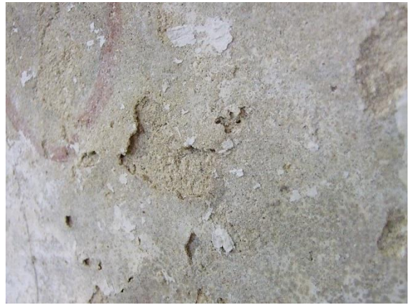
Desquamation et soulèvement de l'enduit (en rose sur la cartographie)
