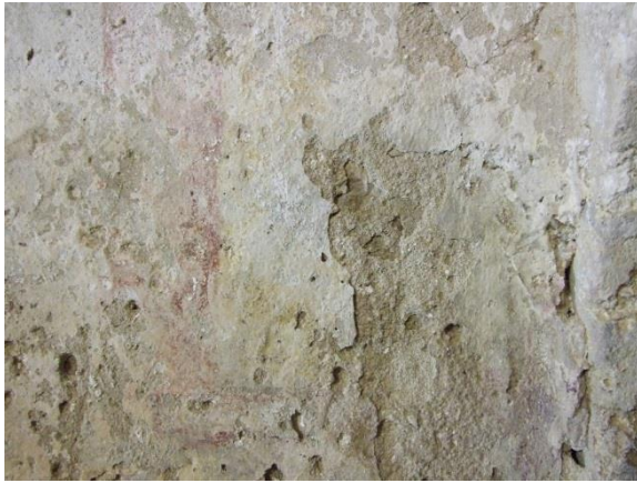
Nef- Soubassements : Bandeau et motifs de draperies recouvertes par un voile de calcite
