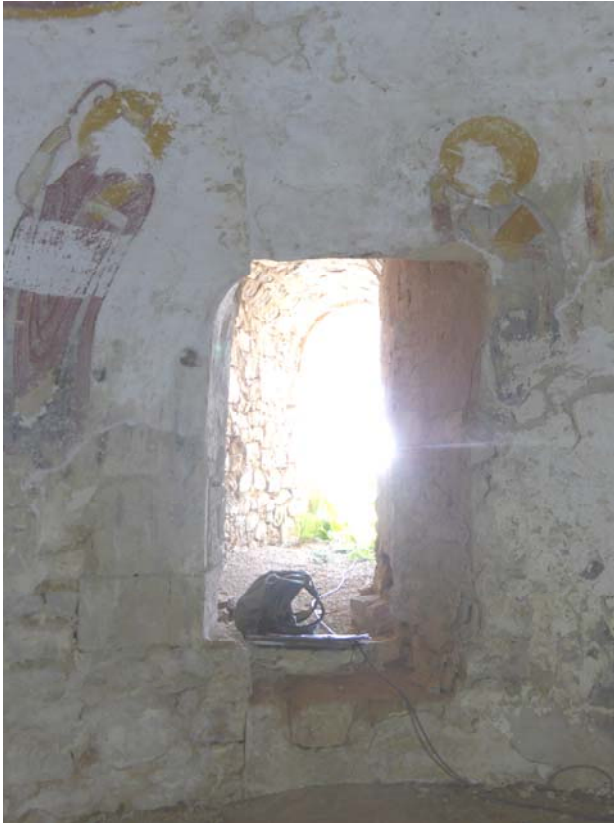
Vue de l'unique accès à l'église basse, ouvert dans une ancienne baie. Le niveau du passage se situe quelques 60 cm au-dessus du niveau actuel de l'église.
