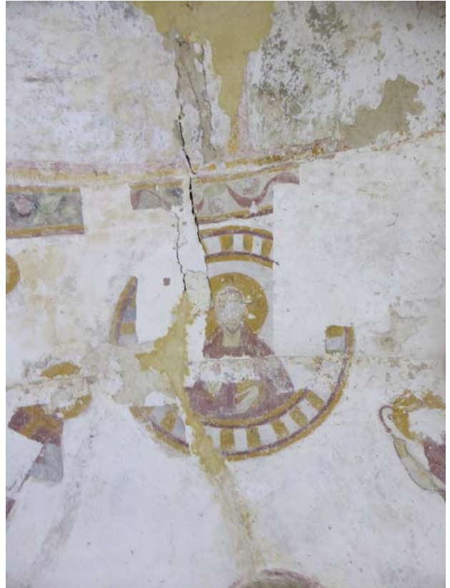
Fissure de la voûte : partant de la fenêtre axiale et se prolongeant jusqu'à l'ouverture rebouchée de la voûte de la nef.
