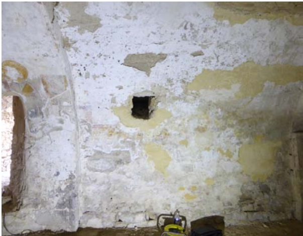
Mur Sud de la crypte : l'enduit est fortement dégradé, surtout en partie basse. Une frise souligne la naissance du berceau de la voûte.
